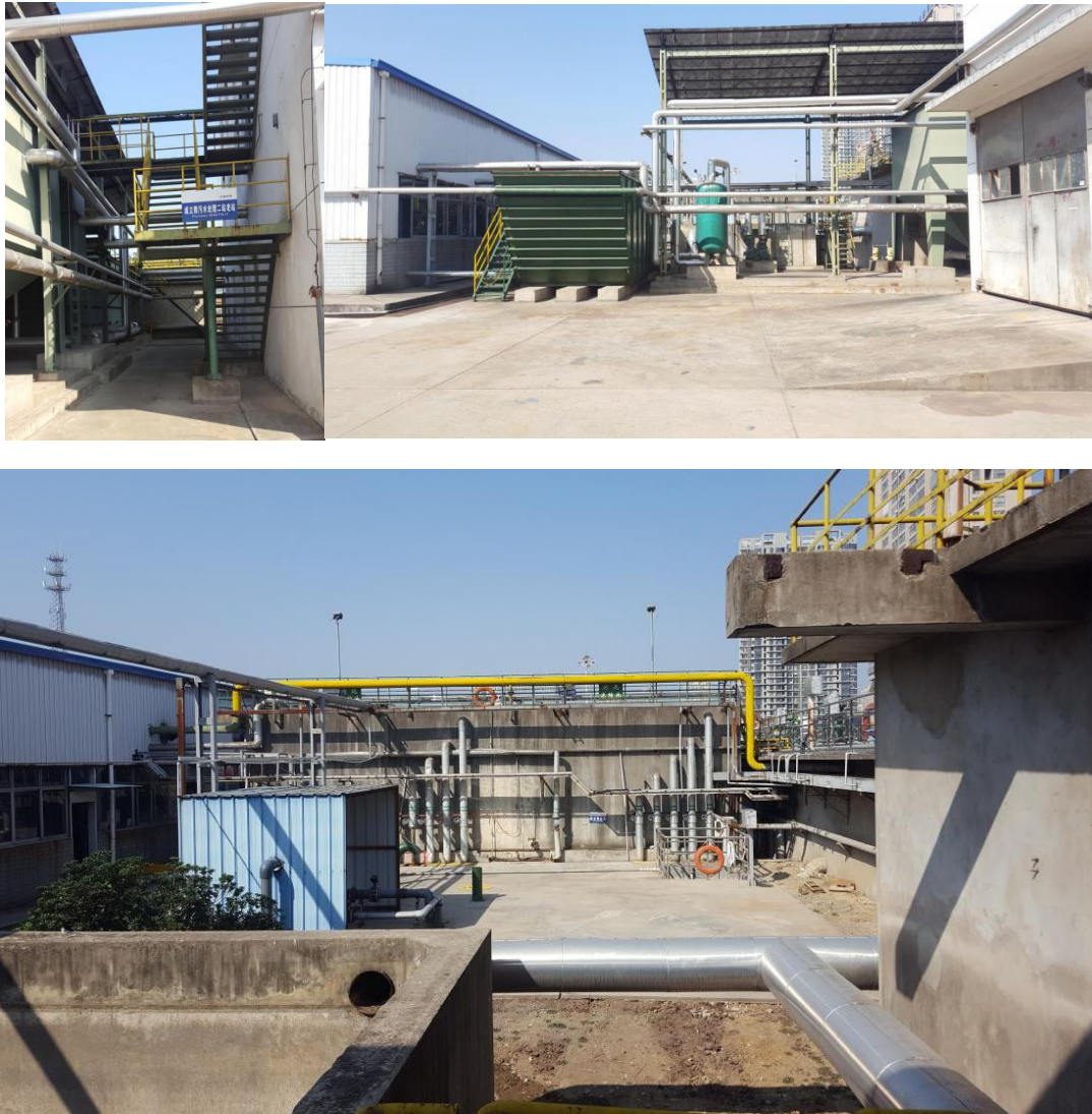
图 3.2-8 安徽江淮汽车集团股份有限公司商务车分公司污水处理站
