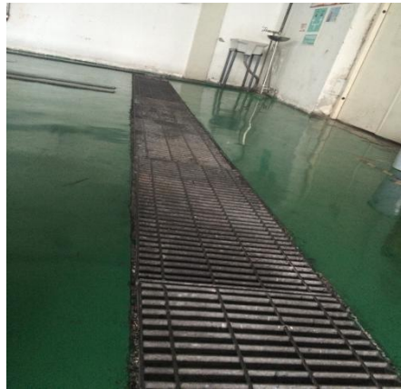
图 3.2-6 涂装车间内导流沟
